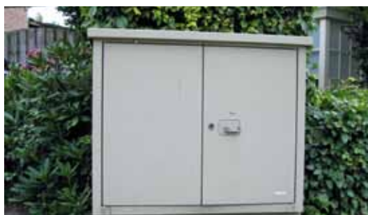
Conventioneel gemetselde middenspanningsruimte, compactstation en laagspanningskast
