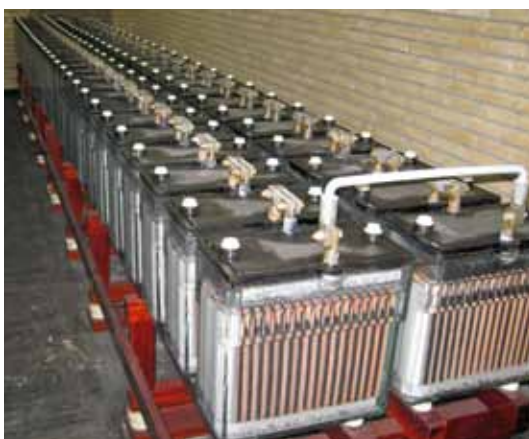
Accu batterij als noodstroomvoorziening voor de secundaire aanleg
