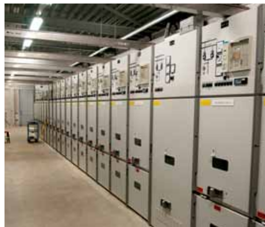
Middenspanningsinstallatie op een hoogspanningsstation
