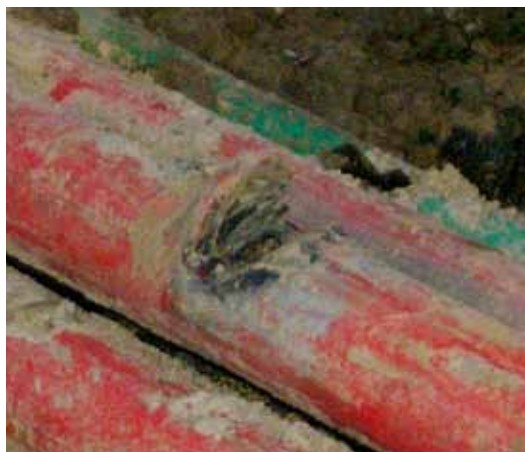
Beschadiging kabel ten gevolge van graafwerkzaamheden
