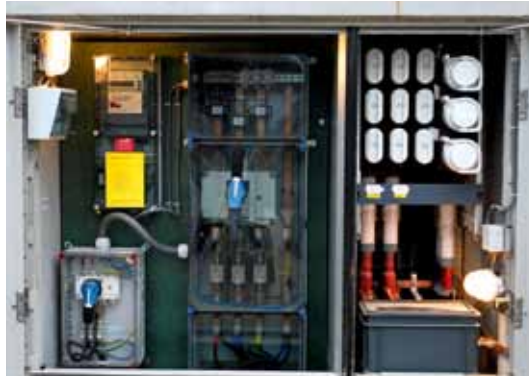
Verschillende soorten middenspanningsruimtes
