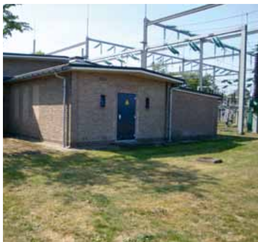
Stationsgebouw op hoogspanningsstation
